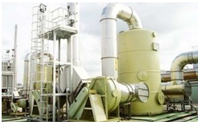
6座RTO(廢氣燃燒爐)
